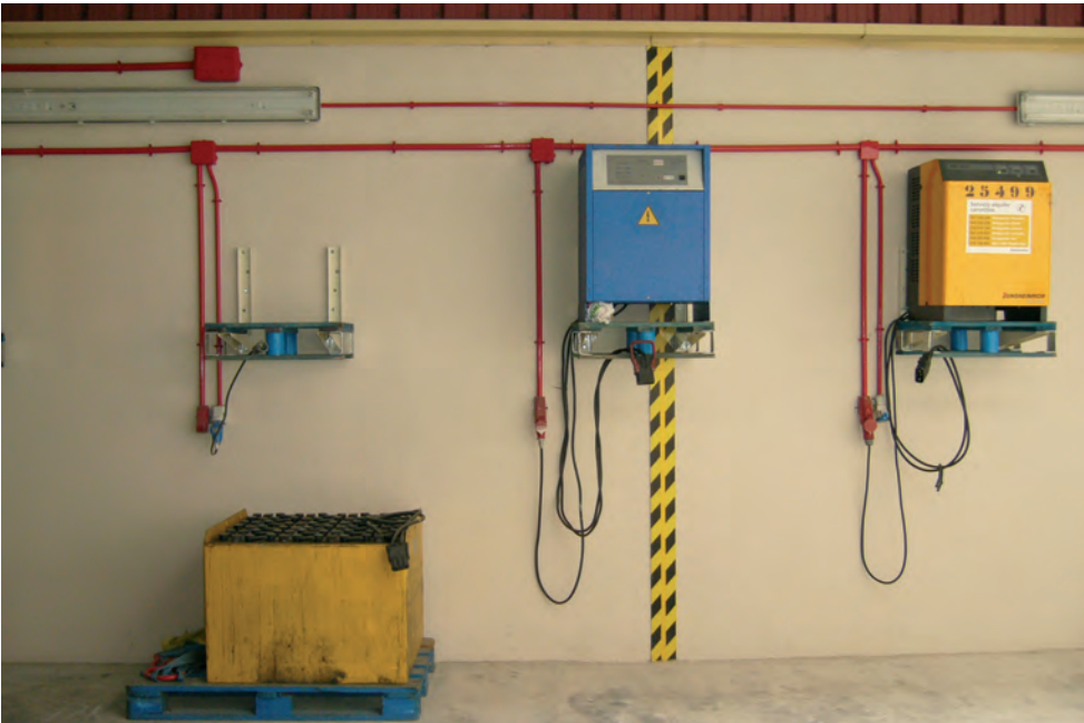
ZONA DE CARGA DE BATERÍAS
